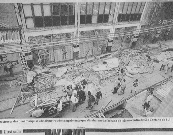
Destroços das duas marquises de 30 metros de comprimento que desabaram da fachada de loja no centro de São Caetano do Sul
