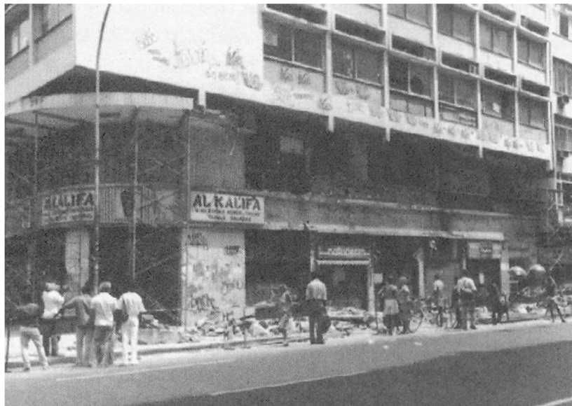
Vista geral da marquise mostrando a parte desabada e a remanescente
