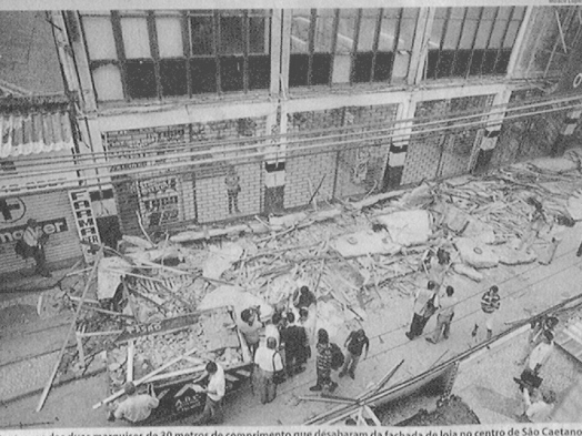
Destroços das duas marquises de 30 metros de comprimento que desabaram da fachada de loja no centro de São Caetano do Sul
