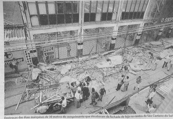
Destrução das duas marquises de 30 metros de comprimento que desabaram da fachada de loja no centro de São Caetano do Sul
