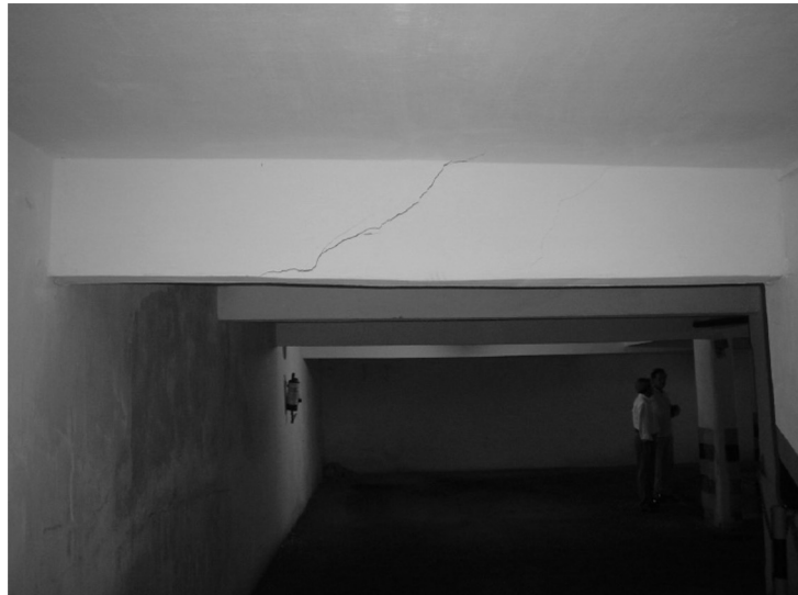
Trinca na viga do teto do subsolo junto a cisterna
