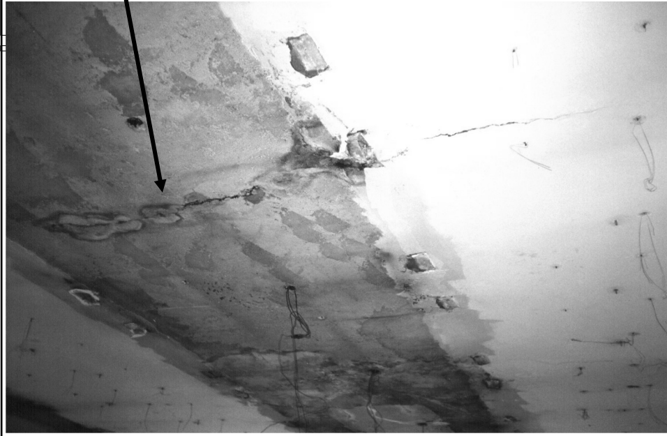
Fissuras com percolação de água
