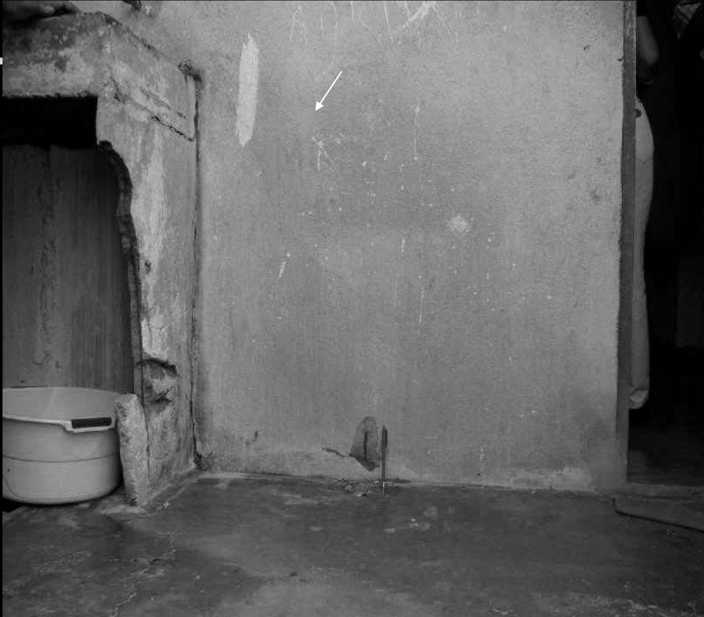
Conjunto Habitacional Santarém, com 15 anos, em Natal - RN, em jan/2001. Corrosão da armadura em parede ao lado de tanque, de área de serviço, em casa na Rua Balsa Nova, 66.
