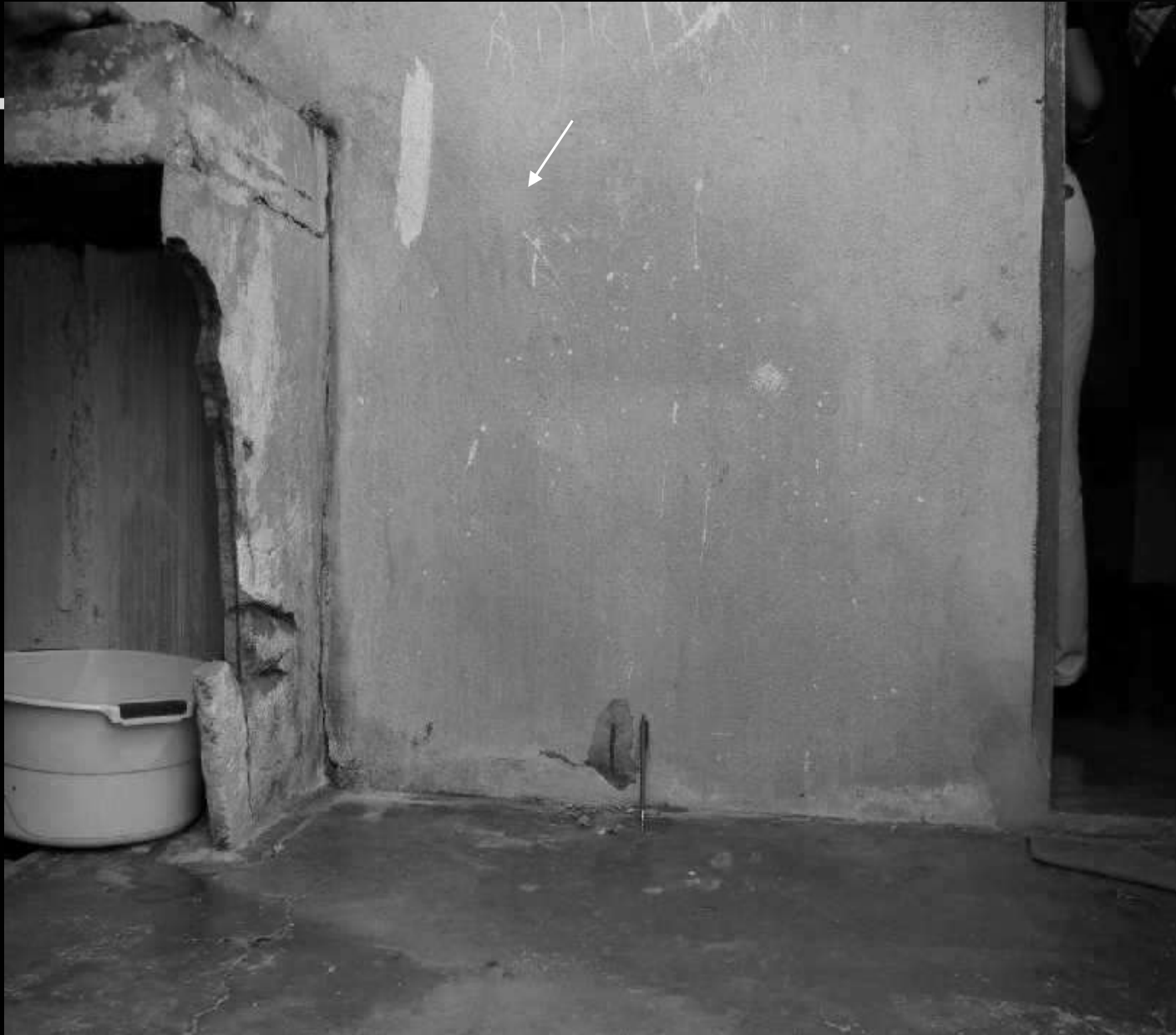
Conjunto Habitacional Santarém, com 25 anos, em Natal - RN, em jan/2001. Corrosão da armadura em parede ao lado de tanque, de área de serviço, em casa na Rua Balsa Nova, 66.
