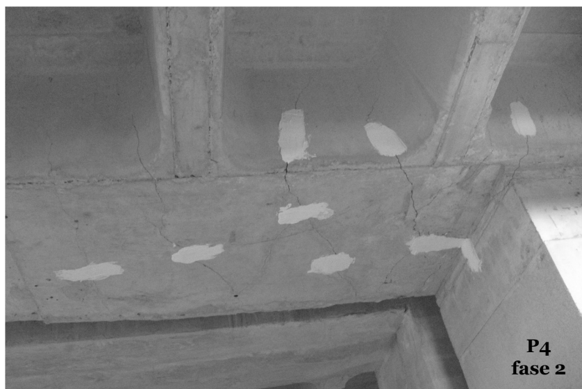
Fissuras em Vigas
