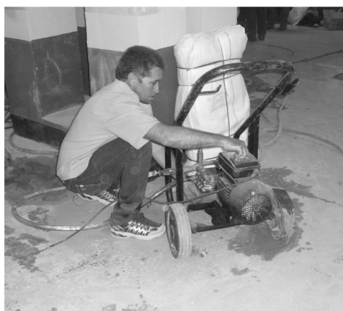
bomba de água sob pressão
