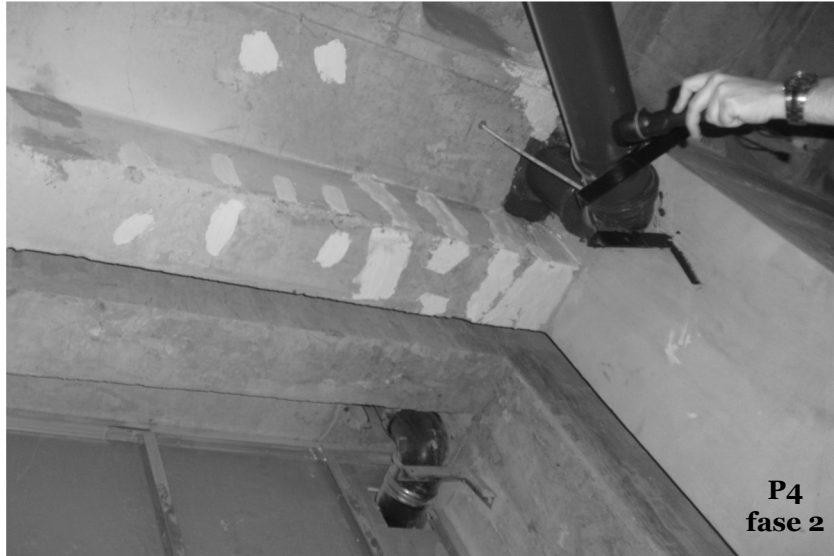
Fissuras em Vigas
