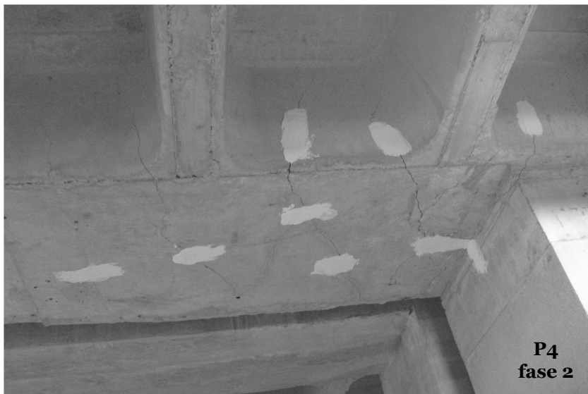
Fissuras em Vigas
