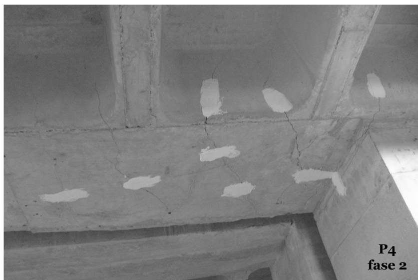
Fissuras em Vigas
