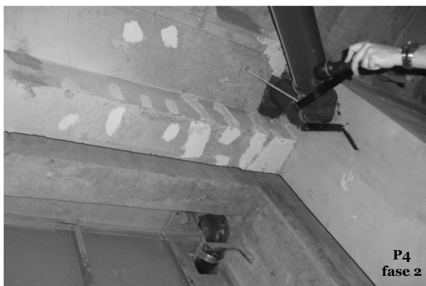
Fissuras em Vigas
