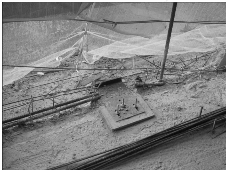
Vigas sendo Demolidas e Cortadas suas Armaduras sem Conhecimento do Projetista
