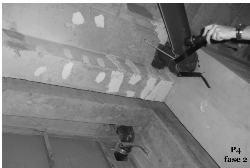
Fissuras em Vigas
