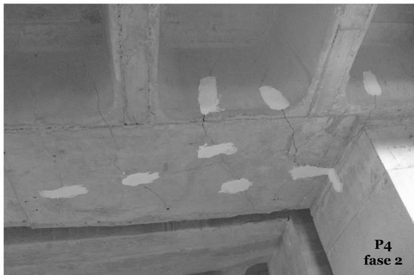
Fissuras em Vigas
