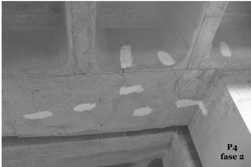
Fissuras em Vigas
