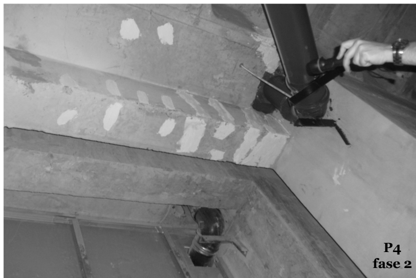
Fissuras em Vigas
