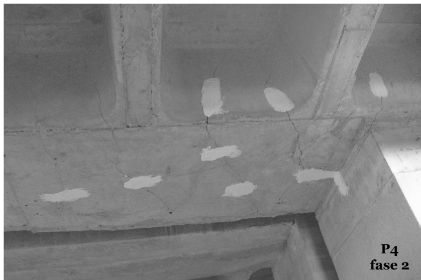
Fissuras em Vigas
