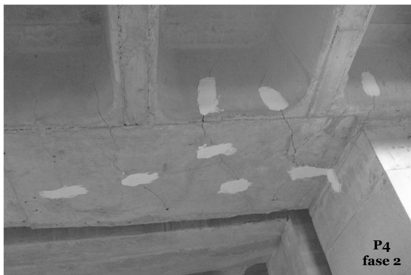
Fissuras em Vigas
