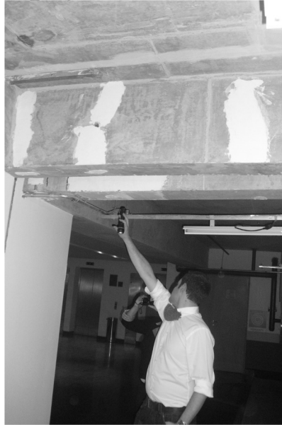
Desnivelamento e fissuras em vigas
