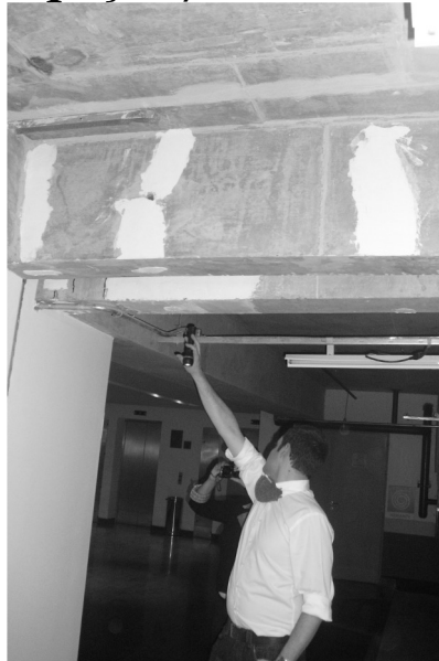
Desnivelamento e fissuras em vigas
