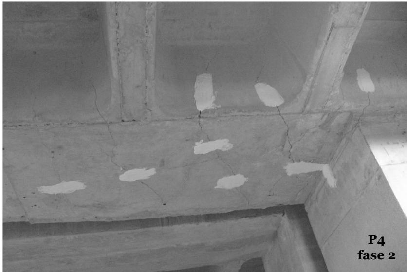
Fissuras em Vigas
