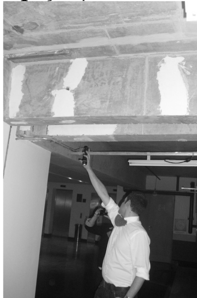
Desnivelamento e fissuras em vigas
