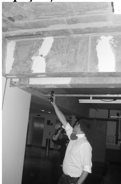
Desnivelamento e fissuras em vigas
