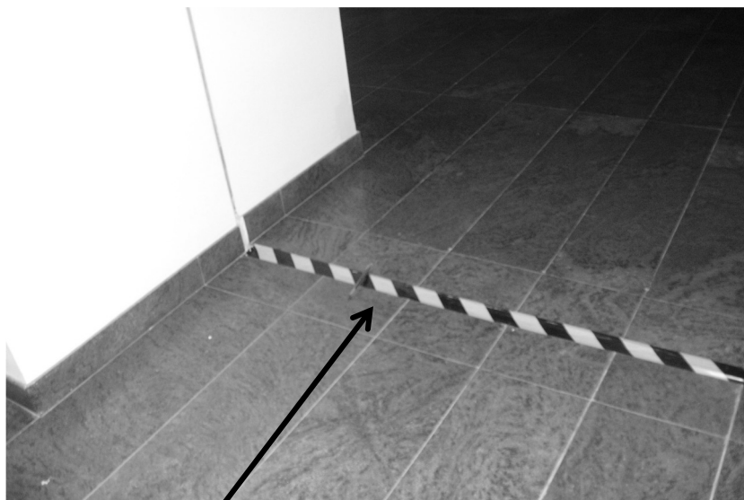
Desnivelamento nível S3
