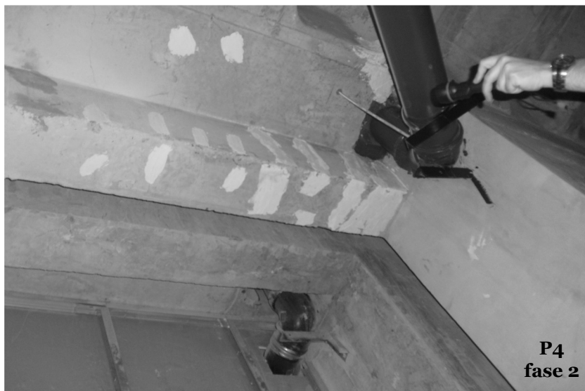
Fissuras em Vigas
