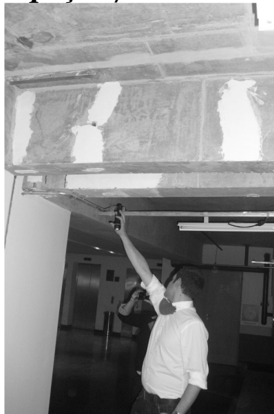
Desnivelamento e fissuras em vigas
