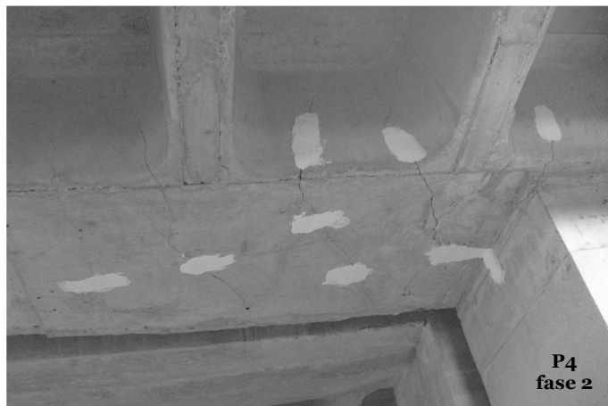
Fissuras em Vigas
