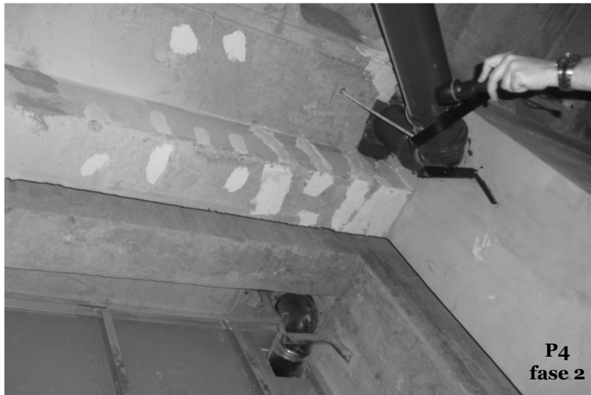
Fissuras em Vigas
