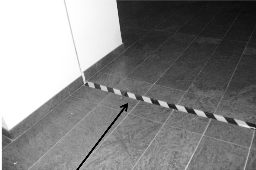
Desnivelamento nível S3
