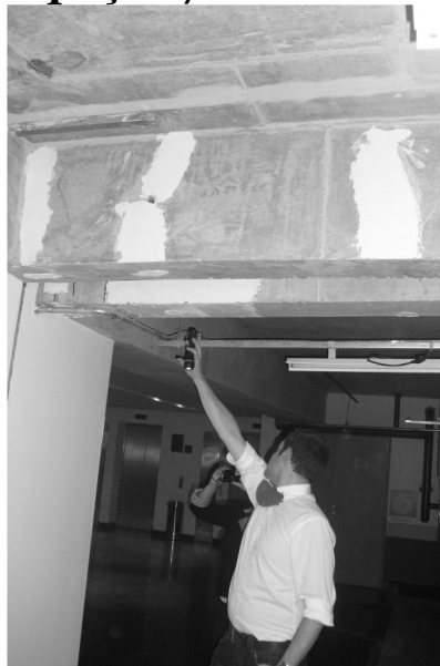
Desnivelamento e fissuras em vigas
