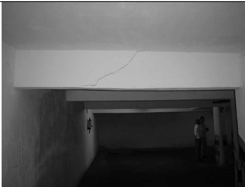
Trinca na viga do teto do subsolo junto a cisterna
