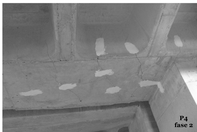
Fissuras em Vigas
