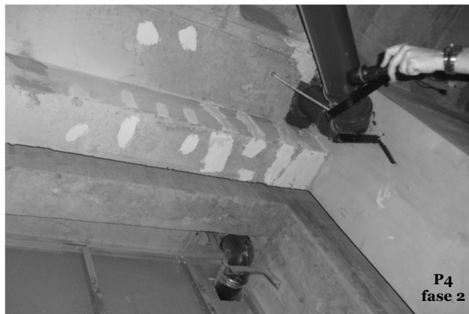
Fissuras em Vigas
