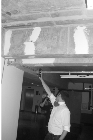
Desnívelamento e fissuras em vigas
