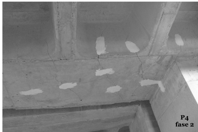
Fissuras em Vigas
