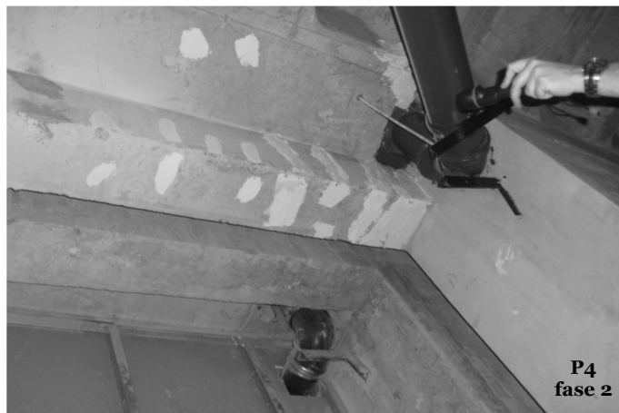
Fissuras em Vigas
