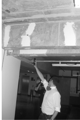
Desnívelamento e fissuras em vigas
