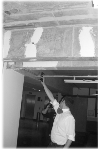
Desnívelamento e fissuras em vigas
