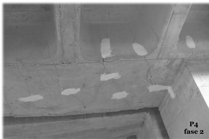
Fissuras em Vigas
