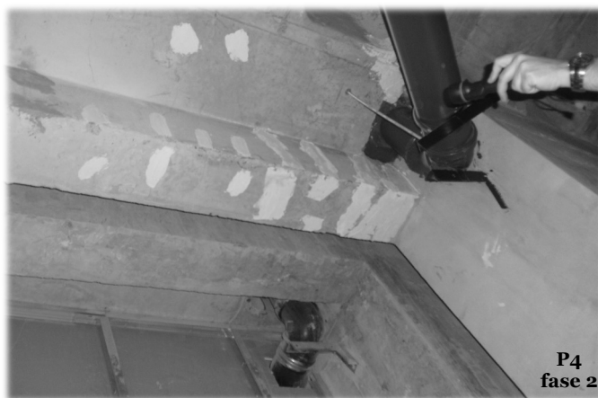
Fissuras em Vigas
