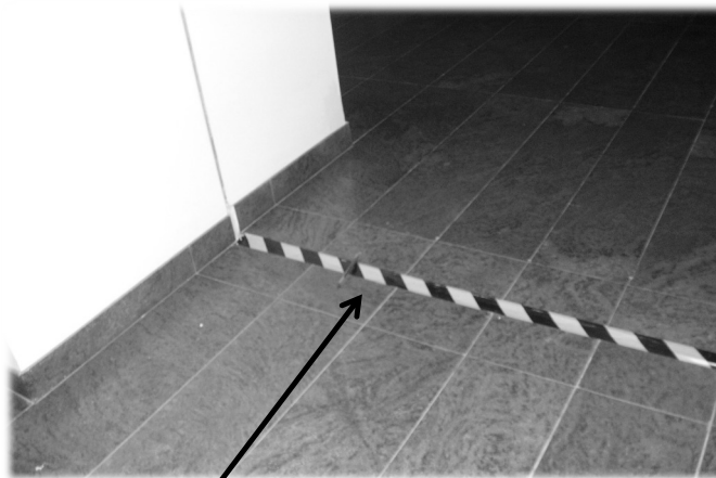
Desnivelamento nível S3
