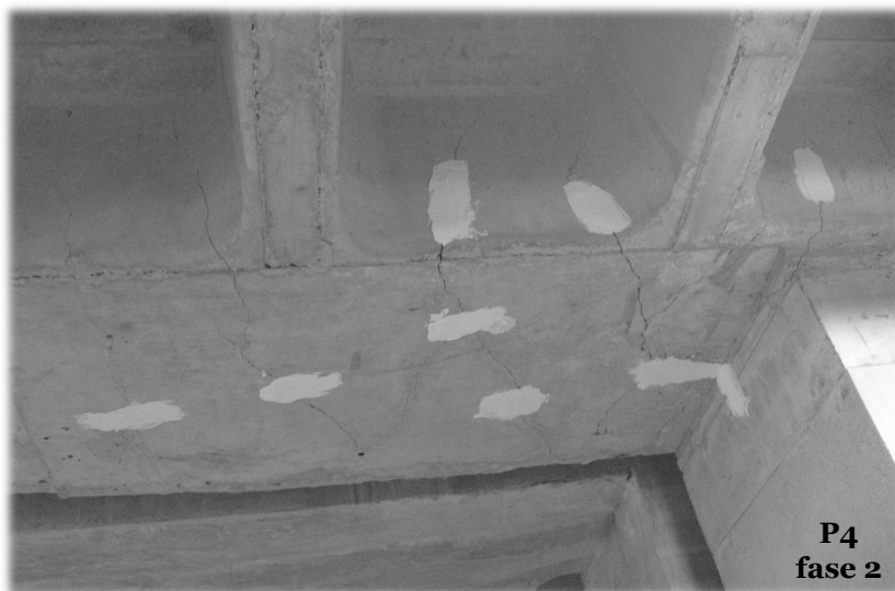
Fissuras em Vigas
