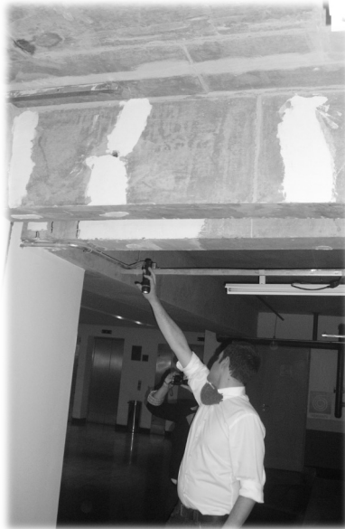
Desnívelamento e fissuras em vigas
