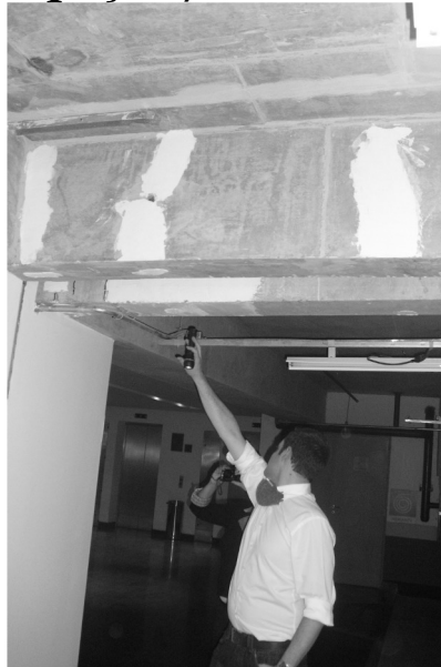
Desnivelamento e fissuras em vigas
