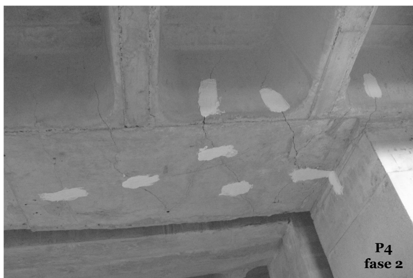
Fissuras em Vigas
