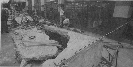
Área interditada em calçada do centro de São Caetano com parte da marquise que desabou de prédio comercial, matando duas pessoas ontem
