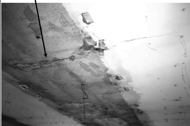
Fissuras com percolação de água
