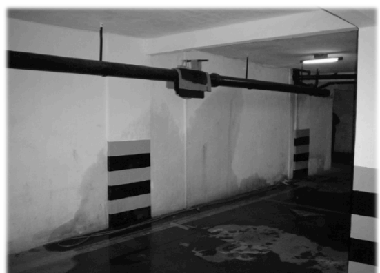
Vista geral do reservatório inferior (cisterna) e alagamento
