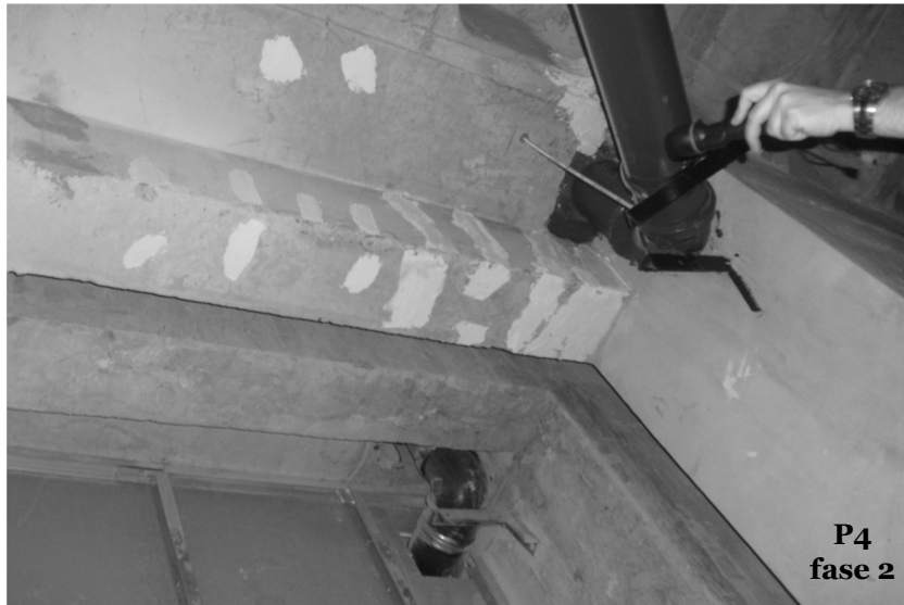
Fissuras em Vigas
