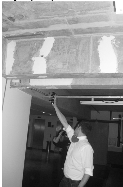
Desnivelamento e fissuras em vigas
