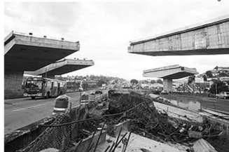
Viaduto do trecho sul do Rodoanel em Embu (SP), onde ocorreu acidente que feriu três pessoas; IPT conclui laudo e aponta causas
