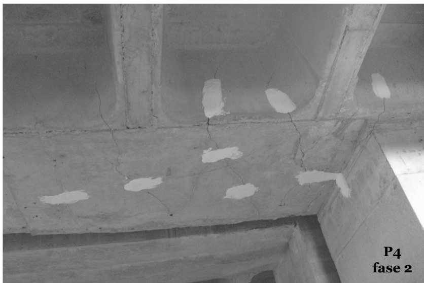
Fissuras em Vigas
