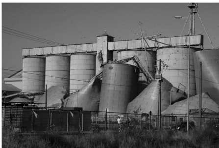
Colapso de Silos
