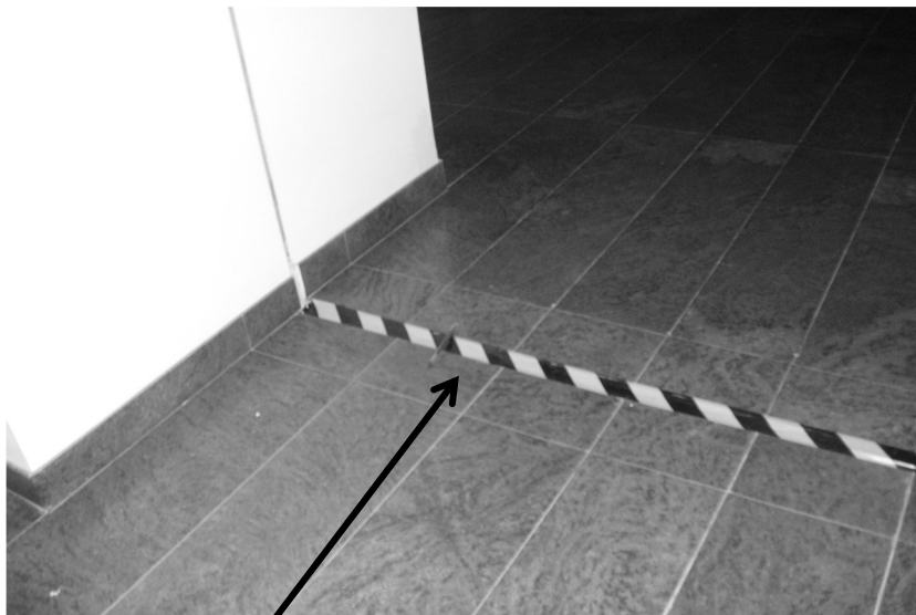
Desnivelamento nível S3
