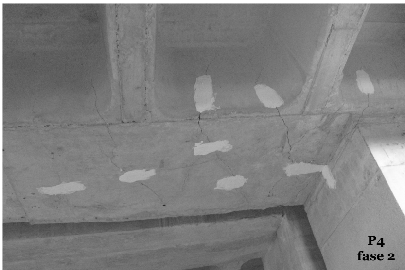
Fissuras em Vigas
