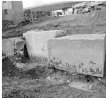
Na imagem, pilar do Batalha dos Guararapes afundado sobre o bloco que se rompeu
