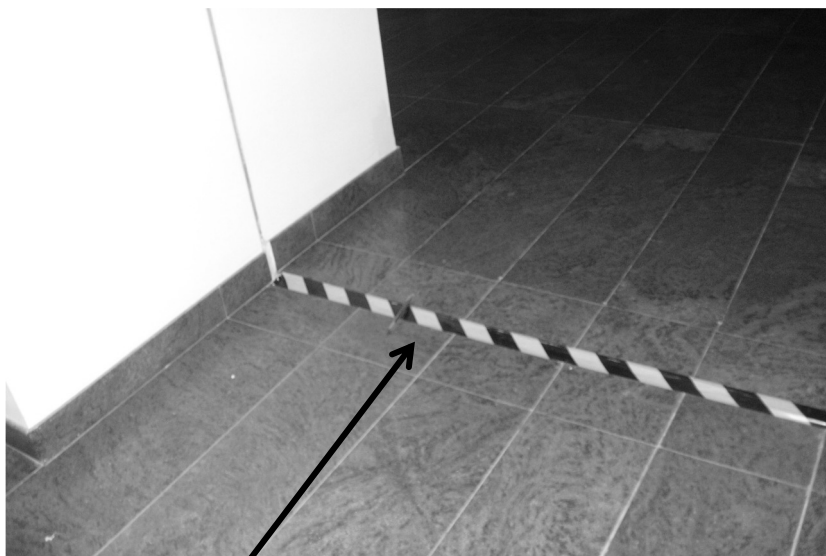
Desnivelamento nível S3
