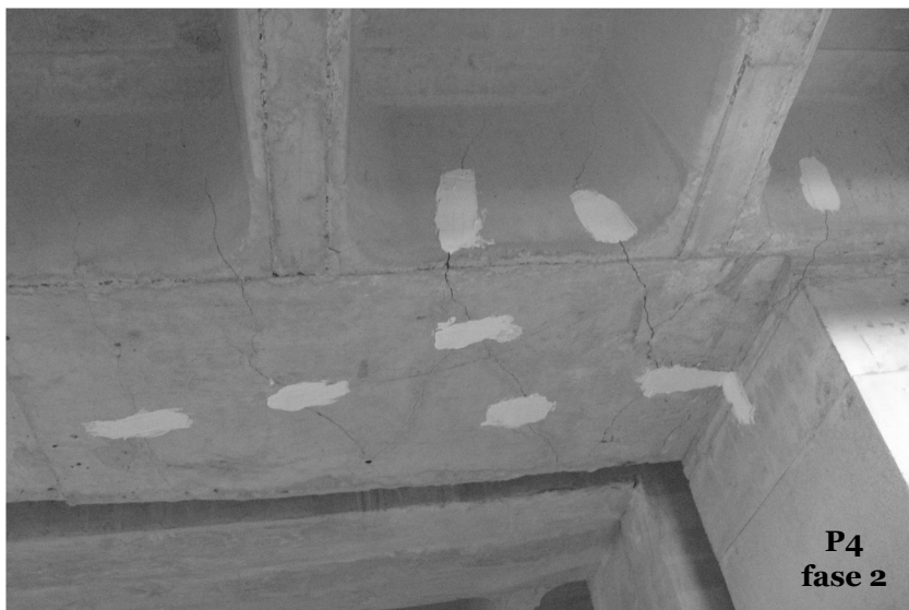
Fissuras em Vigas
