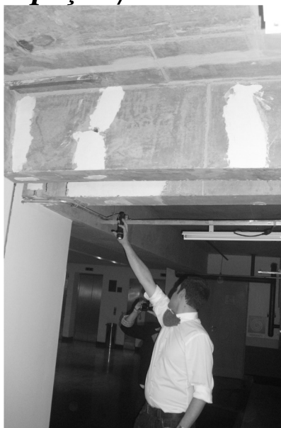
Desnivelamento e fissuras em vigas
