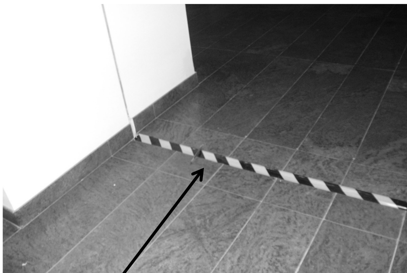
Desnivelamento nível S3
