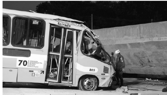
O viaduto, que estava em construção desabou sobre parte de um ônibus, vários caminhões e um veículo que trafegava na Avenida Dom Pedro I, no bairro São João Batista, em Belo Horizonte (Paulo Fonseca/EFE)
