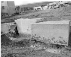
Na imagem, pilar do Batalha dos Guararapes afundado sobre o bloco que se rompeu
