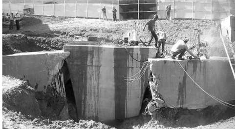
O pilar P3, que afundou pelo meio do bloco devido a dimensões inadequadas, segundo aponta laudo do Instituto de Criminalística
