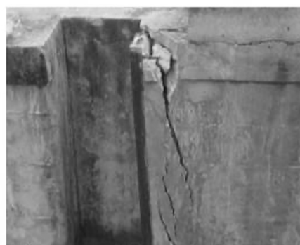
(b) fissura secundárias na guia da comporta da tomada d'água da UHE Paulo Afonso I
