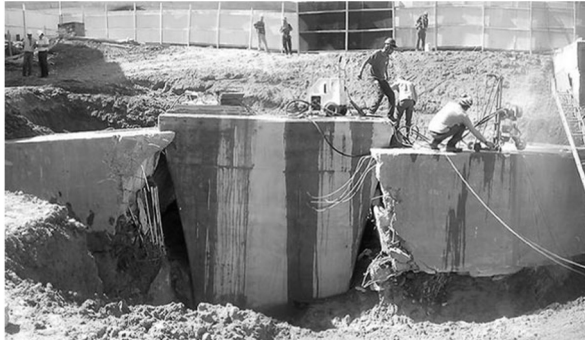
O pilar P3, que afundou pelo meio do bloco devido a dimensões inadequadas, segundo aponta laudo do Instituto de Criminalística
