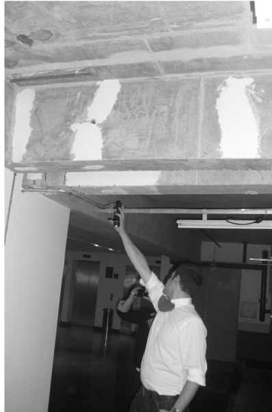
Desnivelamento e fissuras em vigas
