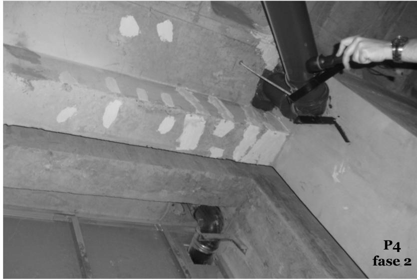
Fissuras em Vigas
