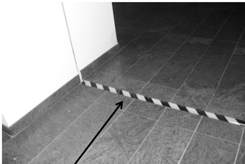
Desnivelamento nível S3
