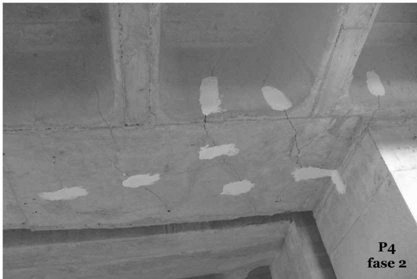
Fissuras em Vigas
