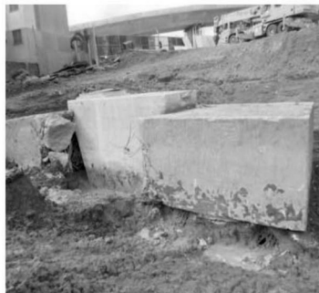
Na imagem, pilar do Batalha dos Guararapes afundado sobre o bloco que se rompeu
