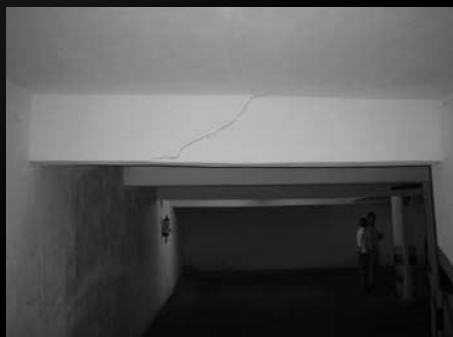
Trinca na viga do teto do subsolo junto ao res. inferior
