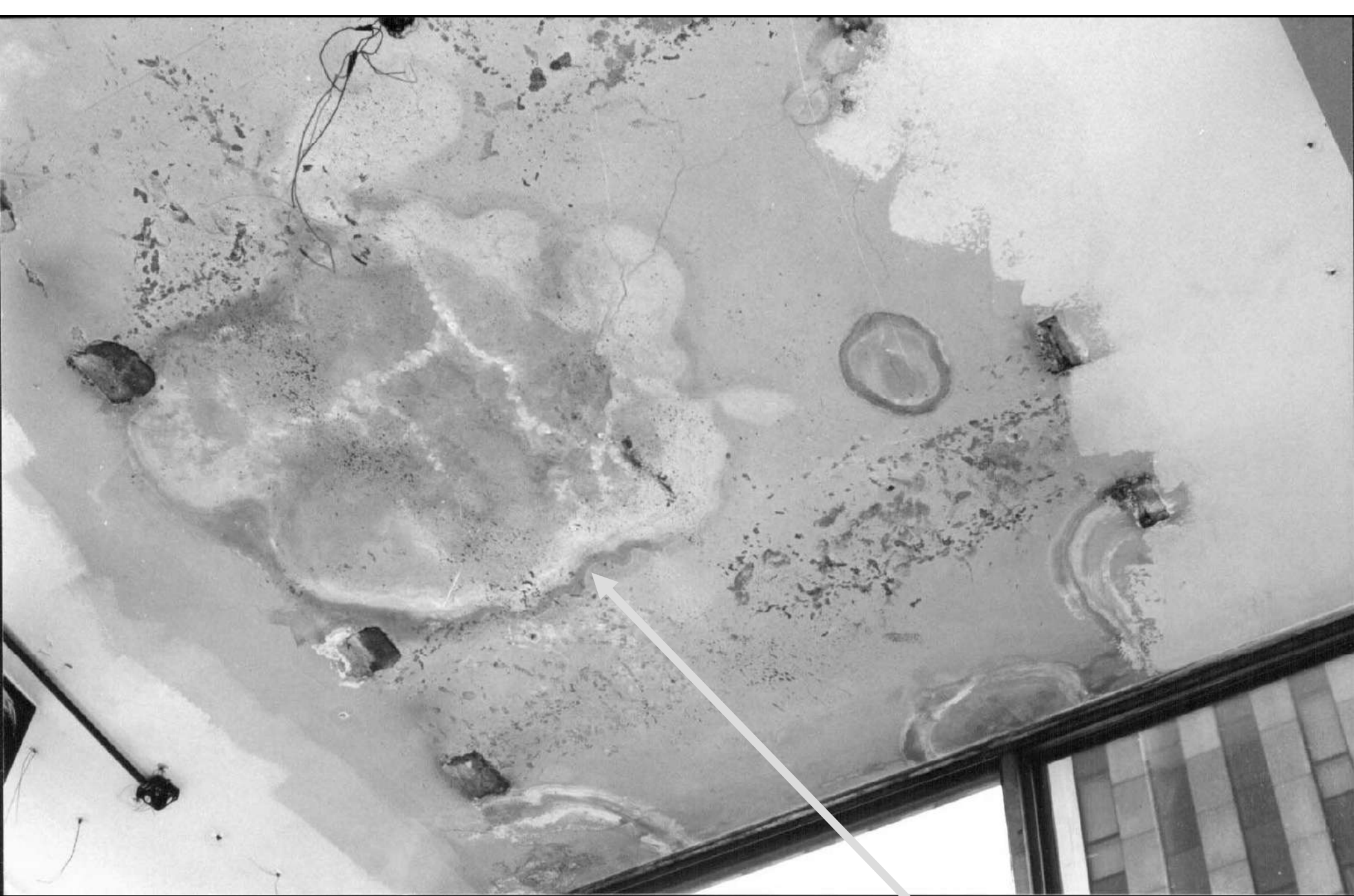
Regiões com manchas de infiltrações
