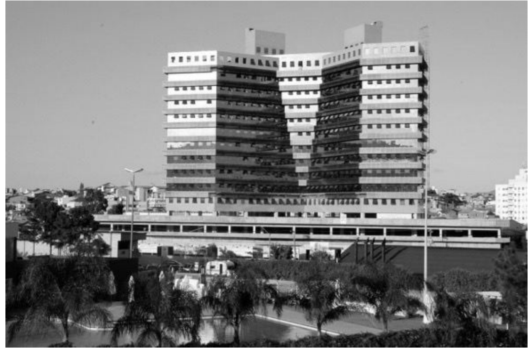
Figura 12 – Obra do Edifício Comercial Terra Firme em São José, SC, com 14 pavimentos em sistema híbrido
