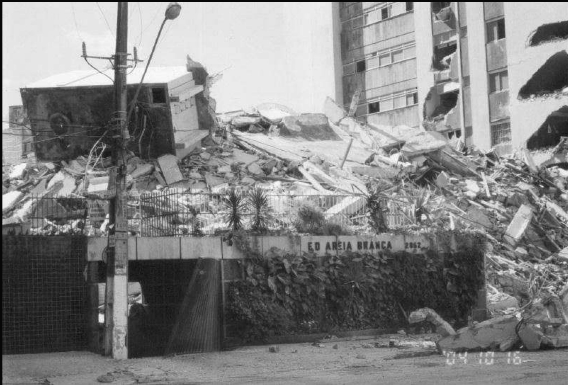
Escombros - manhã seguinte do desabamento
