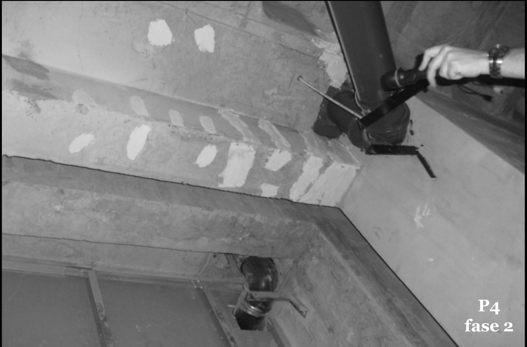
Fissuras em Vigas
