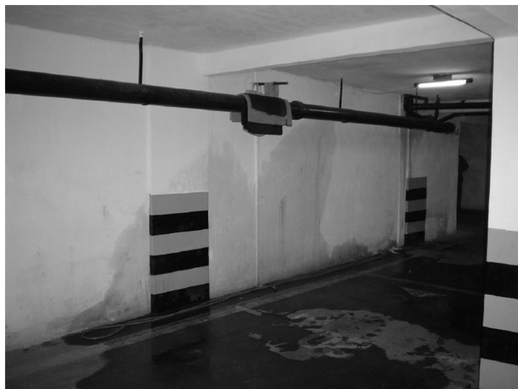
Vista geral do reservatório inferior (cisterna) e alagamento
