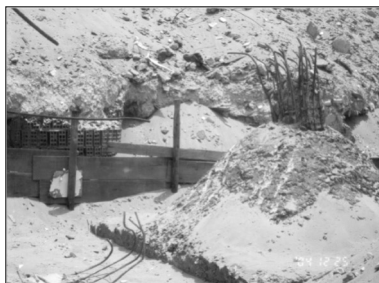
Figura 5- Uma das sapatas analisadas do Edifício Areia Branca, 2004, Pernambuco, Brasil
