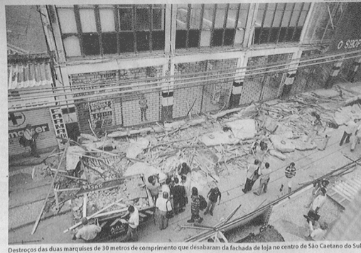
Destruição das duas marquises de 30 metros de comprimento que desabaram da fachada de loja no centro de São Caetano do Sul
