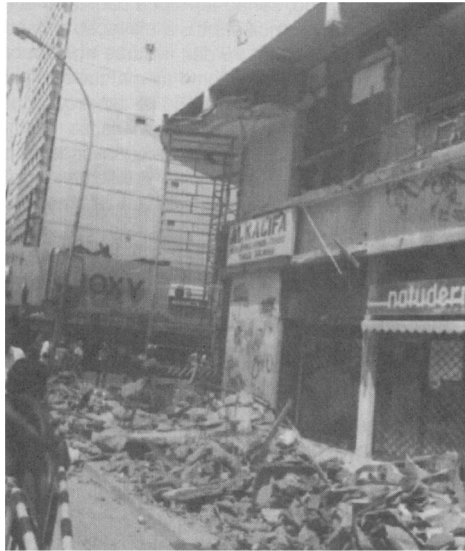
Detalhe para os tirantes em concreto armado no plano da fachada e para os escombros.
