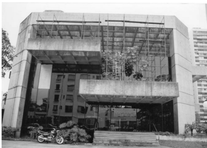
Impregnação de poluição, fungos, etc. no concreto
