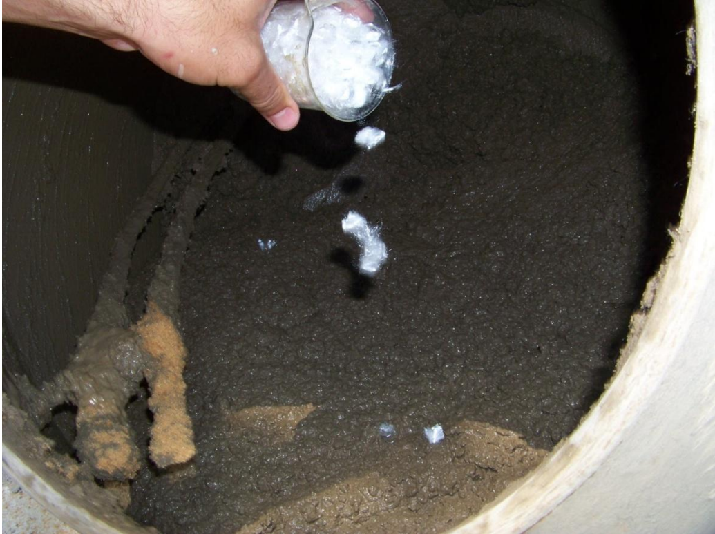
Figura 21: Misturas das Fibras de polipropileno no concreto. (fonte: Autor / data: 28 de agosto de 2012)
