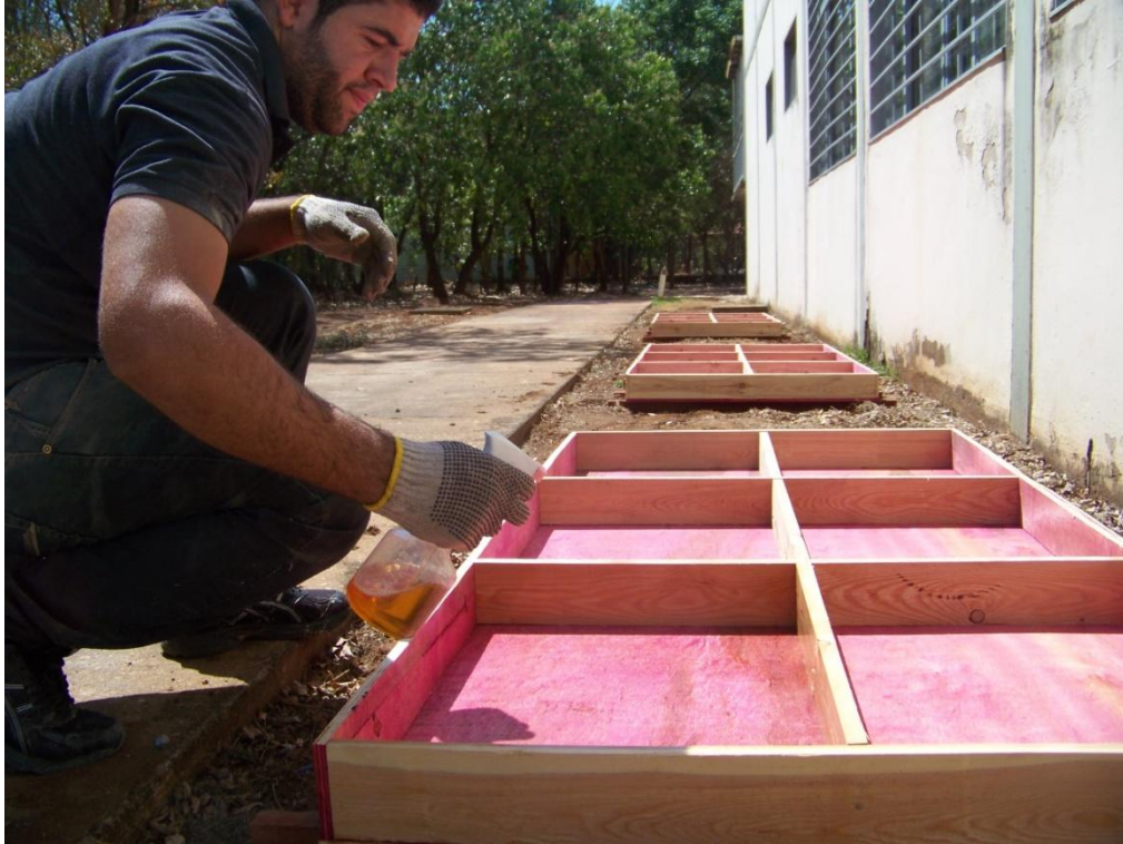
Figura 24: Fôrmas para a concretagem das placas de concreto. (fonte: Autor / data: 28 de agosto de 2012)
