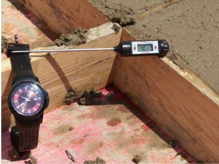
Figura 29: Monitoramento da temperatura ambiente no momento da concretagem. (Fonte: Autor / data: 28 de agosto de 2012).
