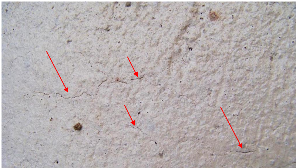
Figura 53: Placa A1 – Concreto referência (sem fibras) – fissuras por retração plástica (fissuras mapeadas) na ordem de 0,05mm à 0,3mm. Data 26 de setembro de 2012. (Fonte: Autor)
