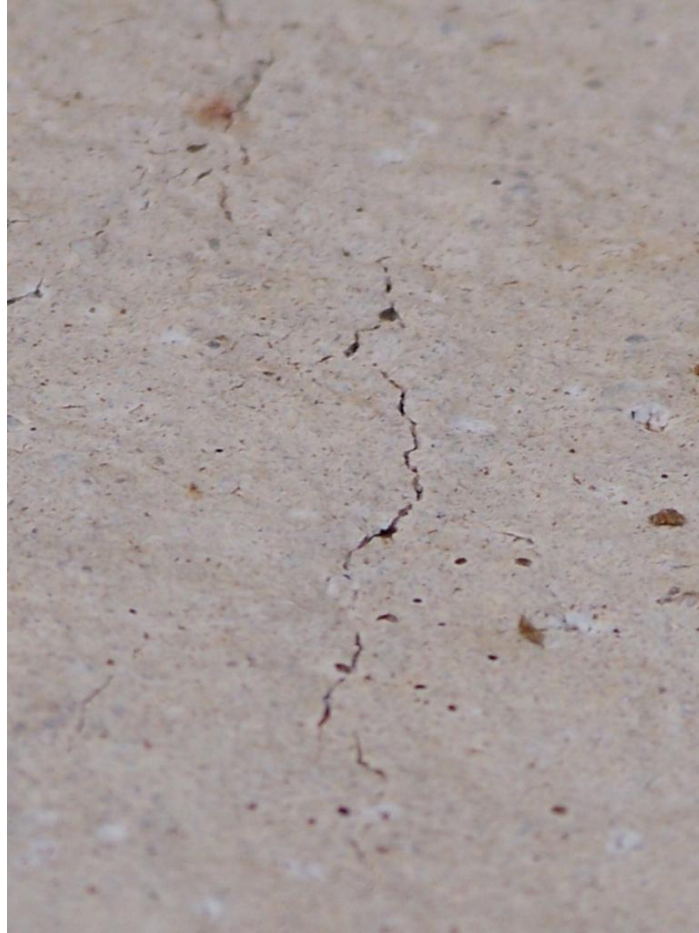
Figura 52: Placa A1 – Concreto referência (sem fibras) – fissuras na ordem de 0,05mm à 0,3mm. Data: 26 de setembro de 2012. (Fonte: Autor)
