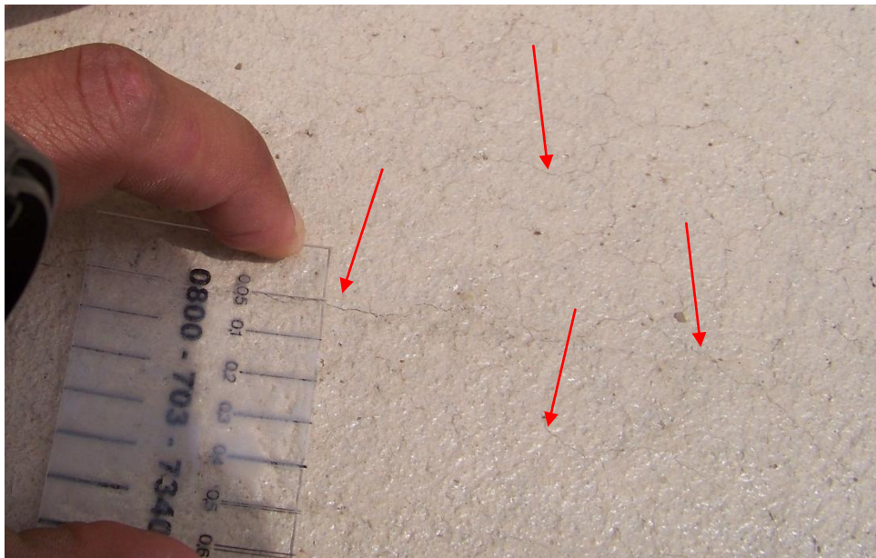
Figura 56: Placa G2 – Concreto com 900\text{ g/m}^3 de concreto, cura ao ar livre – fissuras por retração plástica (fissuras mapeadas) na ordem de 0,05\text{mm} .
