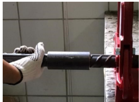
Figura 2-13. Barra de aço sendo instalada na luva de rosca cônica. Fonte: Autor
