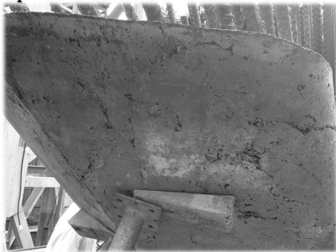
Pilar protótipo - materiais e procedimentos inapropriados
