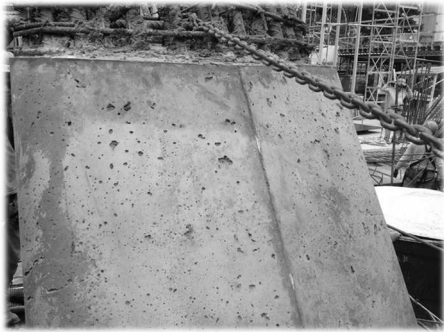
Pilar protótipo - materiais e procedimentos inapropriados
