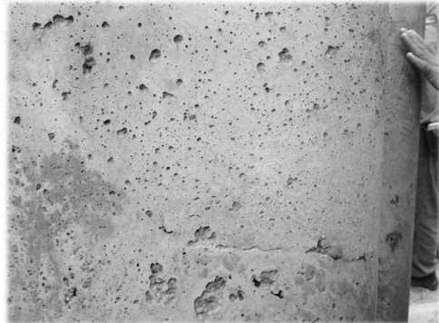
Pilar protótipo - materiais e procedimentos inapropriados
